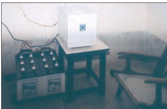
Eén van de twee accu-generatoren die Stichting Amaidhi bekostigd heeft.
